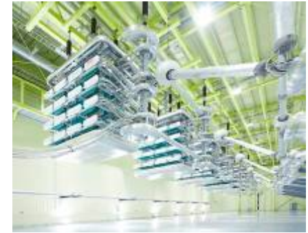
Xiangjiaba-Shanghai (2010) HVDC transmissionslänk 6400 MW \pm 800 kV
